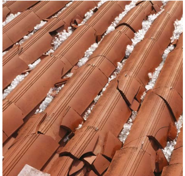
Die Wohngebäudeversicherung deckt auch große Schäden durch Hagelschlag ab. (Foto: © Stillkost / stock.adobe.com)
